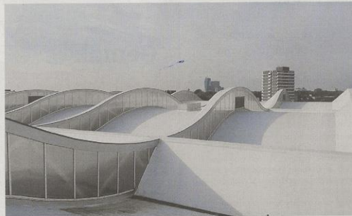
▲ De witte pvc-dakbaan weerkaast straling van de zon optimaal en houdt de warmte buiten. De temperatuur op het dak loopt minder op en de energierekening ook.
