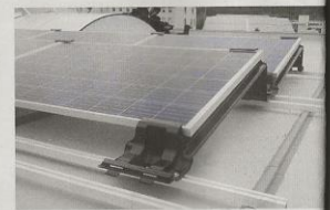
▲ Zonnepanelen zullen op een Cool Roof beter presteren: op een licht dak is de thermische belasting van de PV-installaties lager. Daarnaast zorgt de hogere UV-weerkaatsing voor een hogere opbrengst van PV-panelen.
